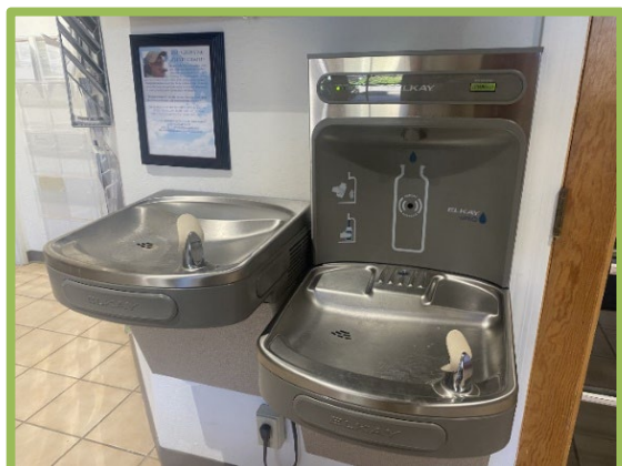
Elemento de Acción 4.3.1 Estación de recarga de botellas de agua para reducir el número de botellas de plástico en las instalaciones municipales.
